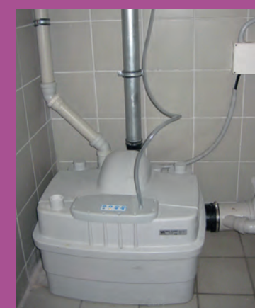
SANICUBIC® 2 Classic instalovaný v suterénu pro odvod odpadních vod
