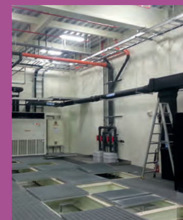
Dva SANICUBIC® 2 Classic instalované v suterénu pro odvod odpadních vod
