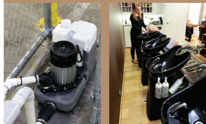
Čerpadlo SANICOM® 1 instalované v kadeřnictví
